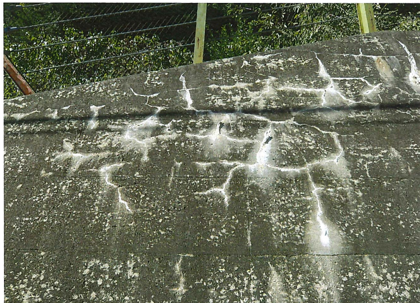
砂質ホルンフェルスによる劣化事例(愛知県 奥三河)
