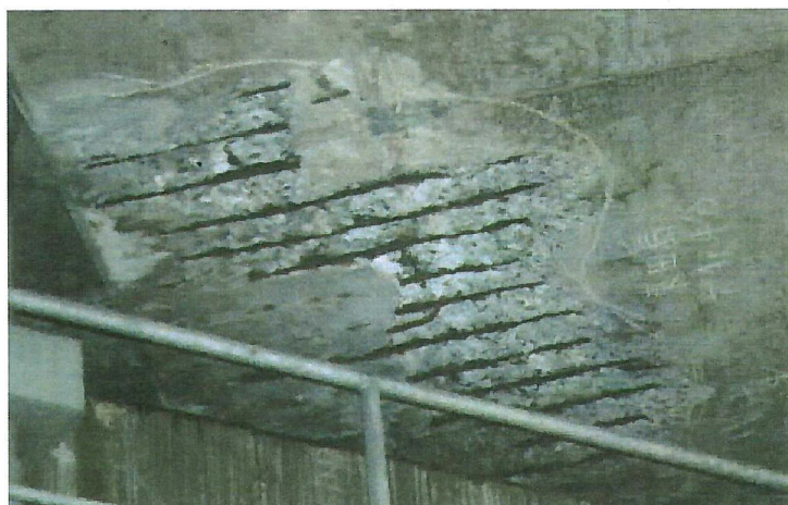
凍結防止剤による劣化事例 (中空RC床版, 北陸道)
