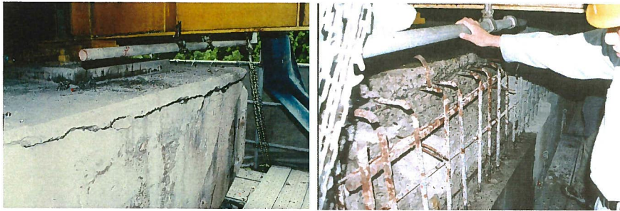
橋脚側面のひび割れ(枕梁)
