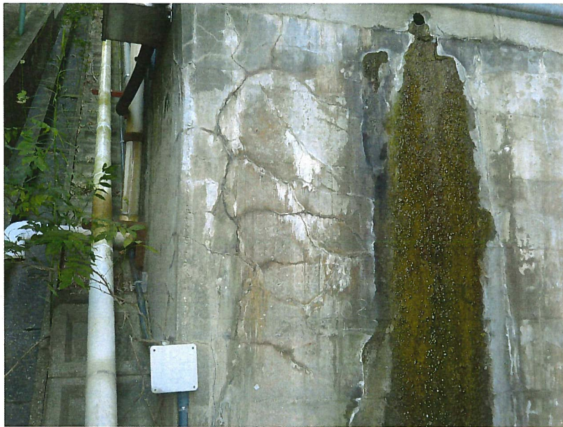
チャートによる擁壁の劣化事例(愛知県)
