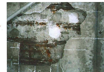
橋脚に発生した塩害
